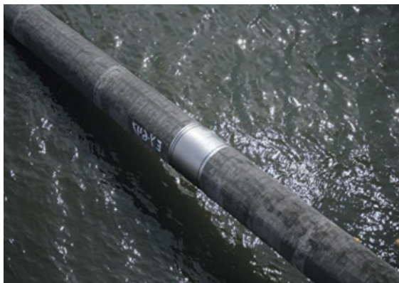
Рис. 3. Фотография размытой оголенной части подводного морского газопровода.
